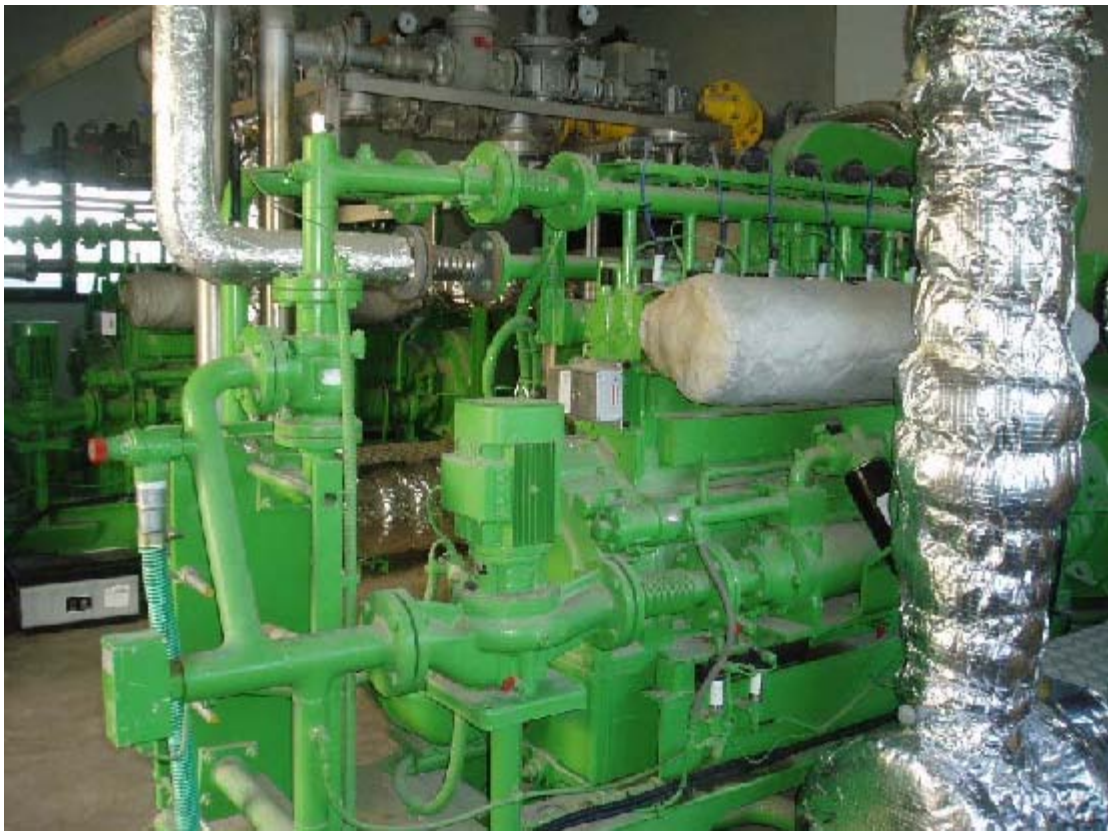
Εικόνα 5.1: Αεριομηχανές (καύση βιοαερίου) (Πηγή: Λυμπεράτος, 2009)
