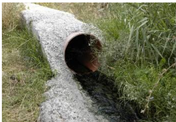
Εικόνα 12: Αγωγός λυμάτων (Πηγή: http://xaidari.blogspot.gr )
