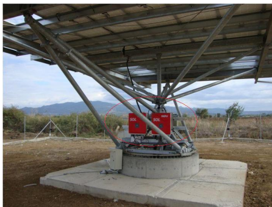
Εικόνα 9: Μετατροπείας τάσης Πηγή: http://www.nais.com.gr/lang_el/projects/view_details/18
