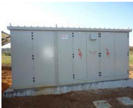
Εικόνα 10: Παράδειγμα υποσταθμού μέσης τάσης Πηγή: http://www.ipel.gr/images/stories/pdfs/profile%20ipel%20-%20%20.pdf
