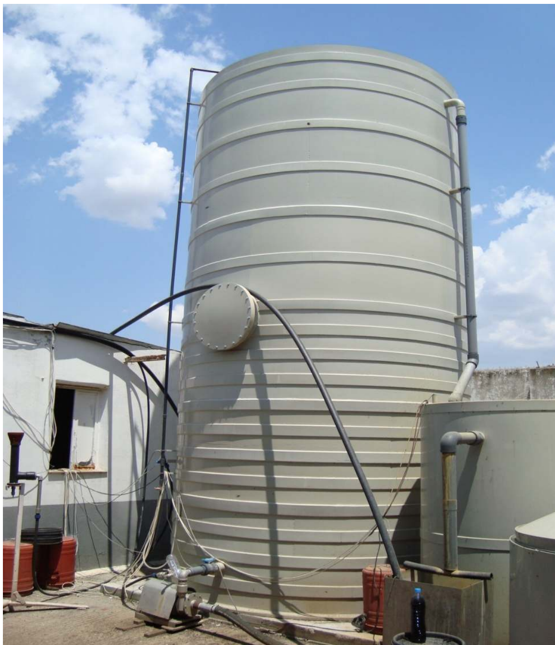
Εικόνα 7.2: Αναερόβιος χωνευτήρας τύπου UASB
