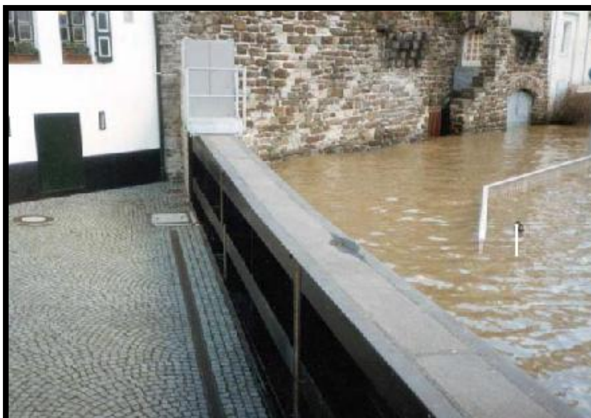
Εικόνα 1.9: Θυροφράγματα για πλημμυρικά νερά (πηγή: Early Warning Systems in the Framework of the Cologne Flood Protection Scheme, Stadtentwässerungs-betriebe Köln, AoR ).
