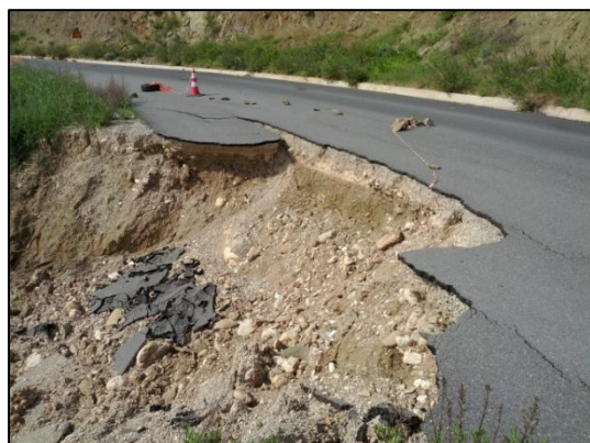
Φωτογραφία 1-2 Επαρχιακή Οδός, 13.5.2012 Photo 1-2 Road failure, date 13.5.2012
