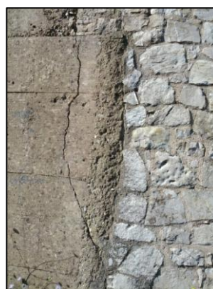
Φωτογραφία 1-5 Ρωγμή σε μάντρα αντιστήριξης στη θέση SL04 Photo 1-5 Wall crack, SL04 area
