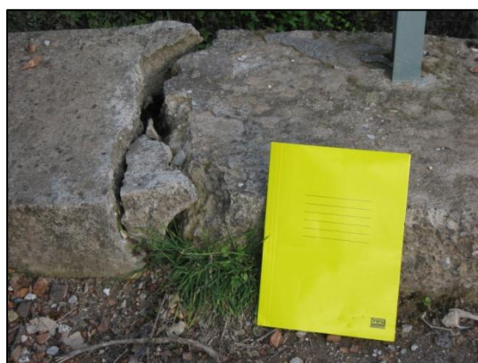
Φωτογραφία 1-4 Σπάσιμο γεφυριού στο ρέμα Κουνάβι, θέση SL01 Photo 1-4 Concrete break on bridge, SL01 area
