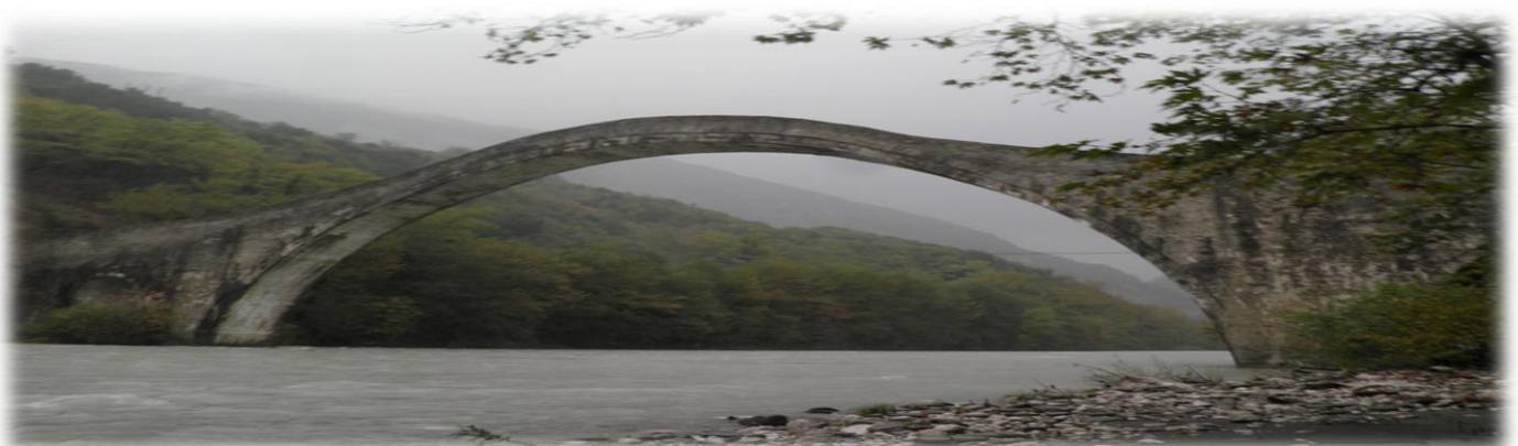
Εικόνα 1.7. Το τοξωτό γεφύρι Πλάκας έχει τη μεγαλύτερη διάμετρο τόξου, εντός του Ελλαδικού χώρου
