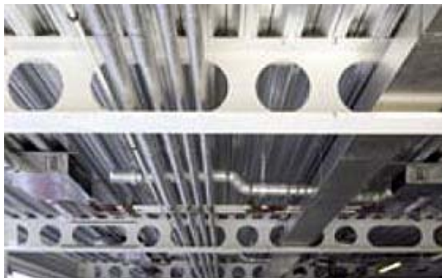
Εικόνα 2.9: Οι σωληνώσεις διέρχονται μέσα από τις δοκούς
