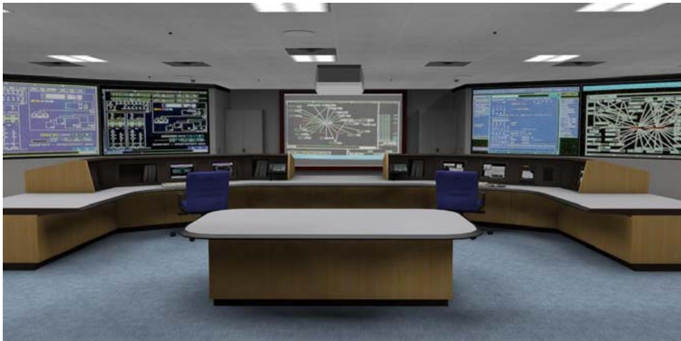
Εικόνα 3.7: Κέντρο ελέγχου και κατανομής φορτίου
