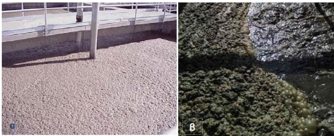
Εικόνα 2.4 Νηματοειδής αφρός στη βιολογική βαθμίδα (α) στην ανοξική δεξαμενή και (β) στη δεξαμενή αερισμού
