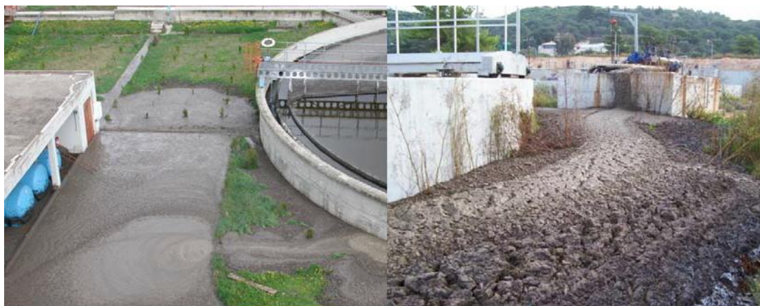
Εικόνα 2.2 Αστοχία δεξαμενής τελικής καθίζησης ΕΕΛ λόγω νηματοειδούς διόγκωσης (Πηγή : Μαρνέρη,2010)
