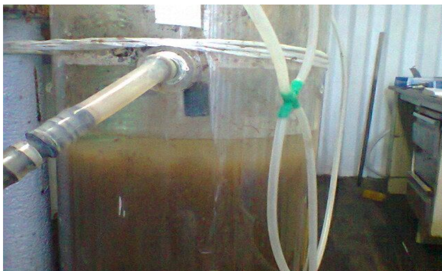
Εικόνα 4.8 Κακή Συμπύκνωση Ιλύος στη ΔTK
