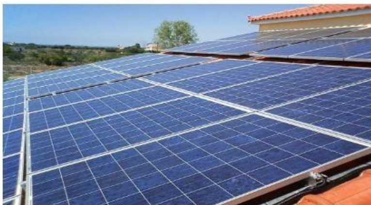
Σχήμα 5.12 Φωτοβολταϊκή εγκατάσταση σε στέγη
