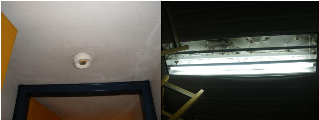
Εικόνα 20: Κατεστραμμένα φωτιστικά σώματα.
