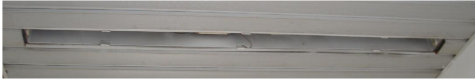
Εικόνα 19: Φωτιστικό σώμα από το οποίο έχει αφαιρεθεί ο λαμπτήρας.
