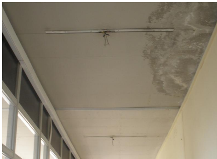
Εικόνα 21: Τα φωτιστικά σώματα έχουν αφαιρεθεί.
