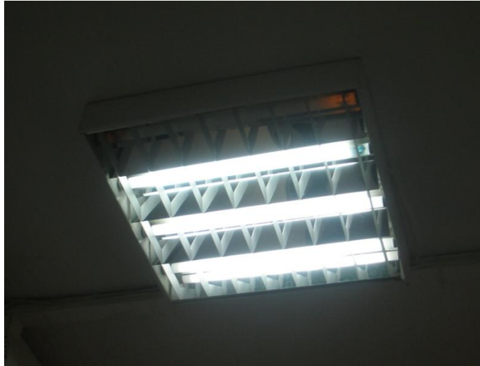
Εικόνα 22: Ο λαμπτήρας δεν λειτουργεί, αλλά το ηλεκτρομαγνητικό ballast εξακολουθεί να καταναλώνει ηλεκτρική ενέργεια.
