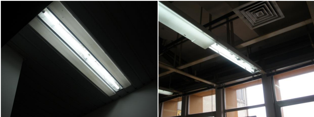
Εικόνα 18: Φωτιστικά σώματα από τα οποία έχει αφαιρεθεί το διαχυτικό κάλυμμα ή έχει καταστραφεί.
