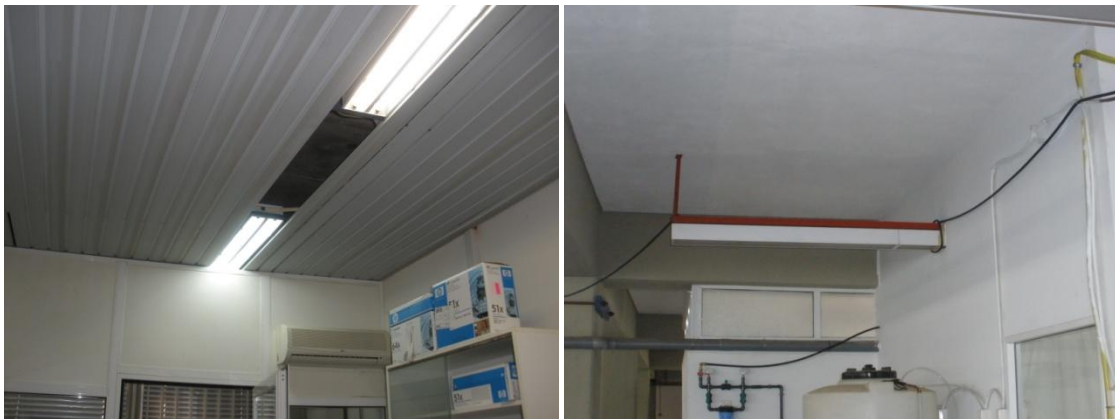
Εικόνα 23: Φωτιστικά σώματα τα οποία έχουν διαιρεθεί σε γειτονικούς χώρους.
