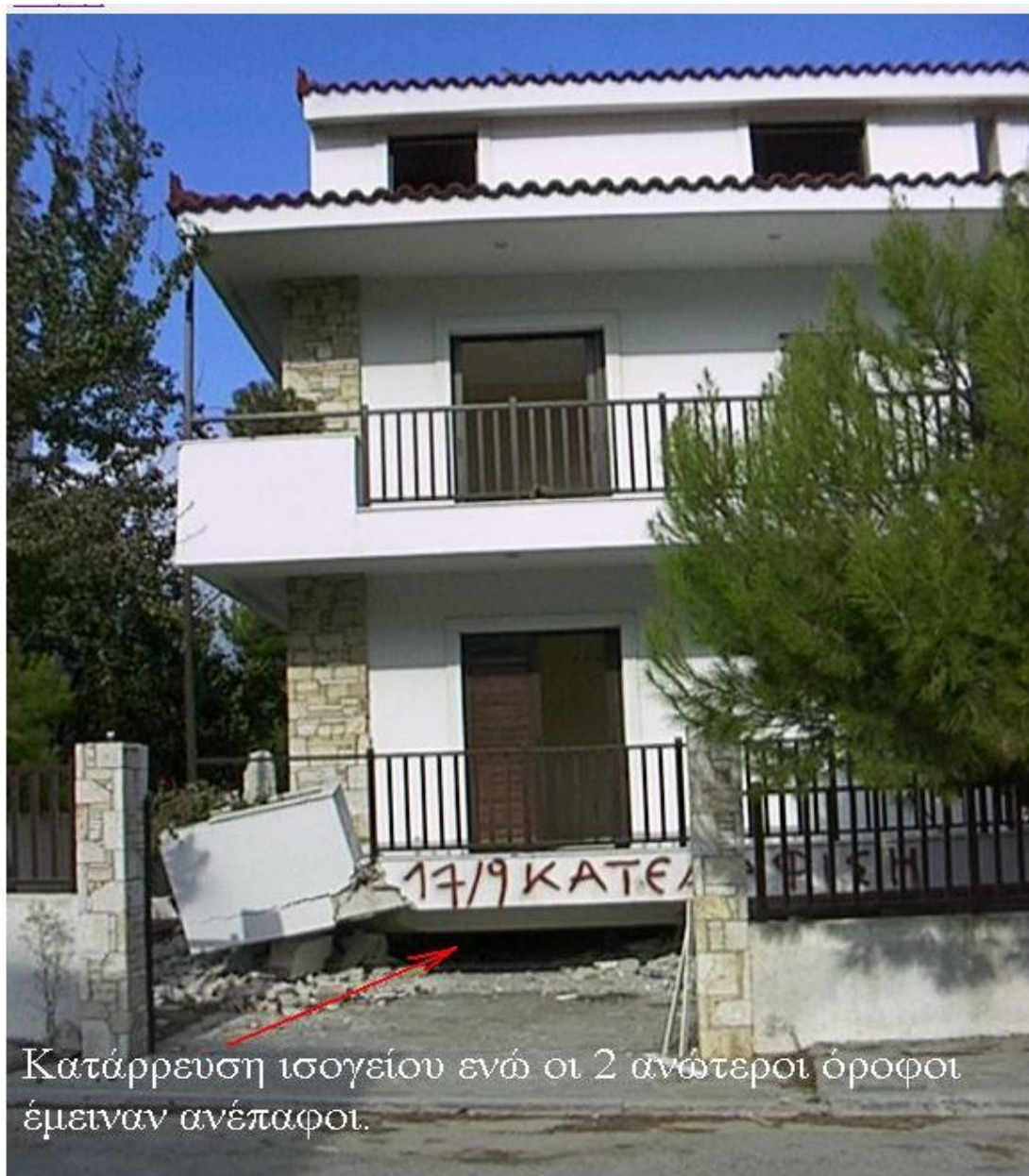
Εικόνα 2.1 Κατάρρευση «μαλακού» ισογείου
