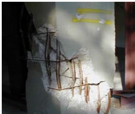
Εικόνα 2.3: Βλάβη λόγω ανεπάρκειας συνδετήρων
