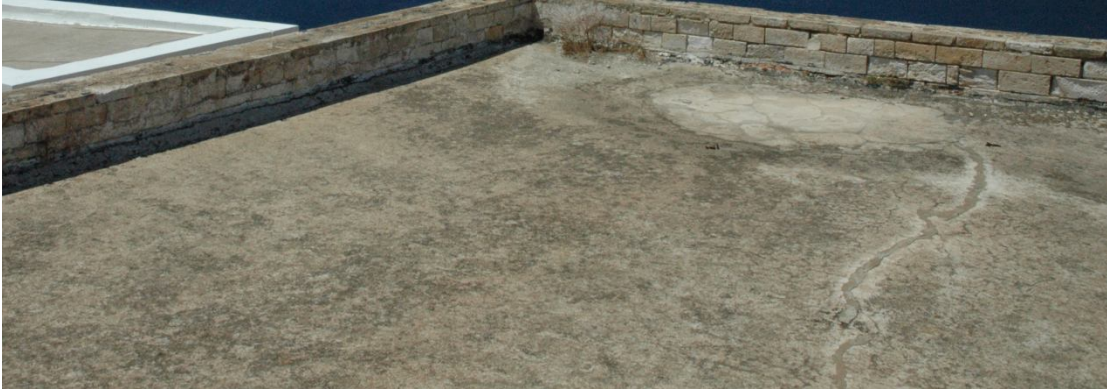
Σχ.5.2.1 ρηγματώσεις & άνοιγμα αρμών δώματος
