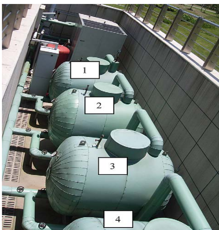
Εικόνα 6.1.3.4. Δεξαμενές αποθήκευσης ζεστού νερού[26]
