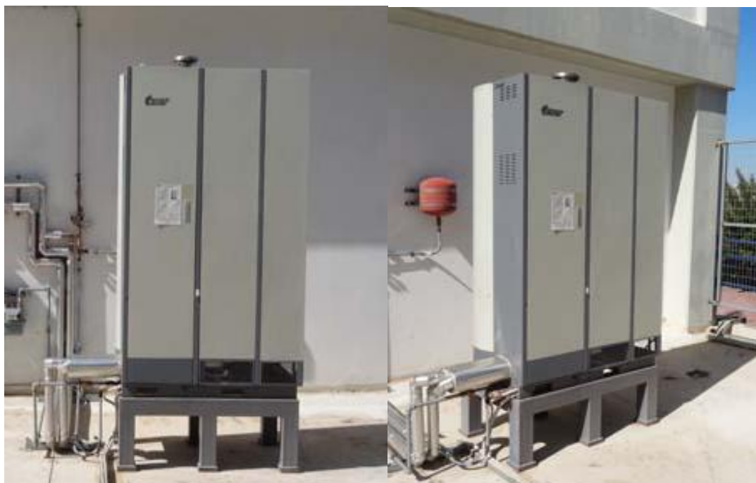
Εικόνα 5.1.1. Ψύκτης απορρόφησης BCT-16 εγκαταστημένος στο εργαστήριο εφαρμοσμένης θερμοδυναμικής του ΕΜΠ.
