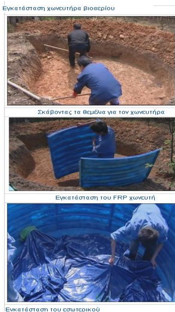
Εικόνα 27. Εγκατάσταση χωνευτή βιοαερίου (Agricultural Development Co.,Ltd, 2010)
