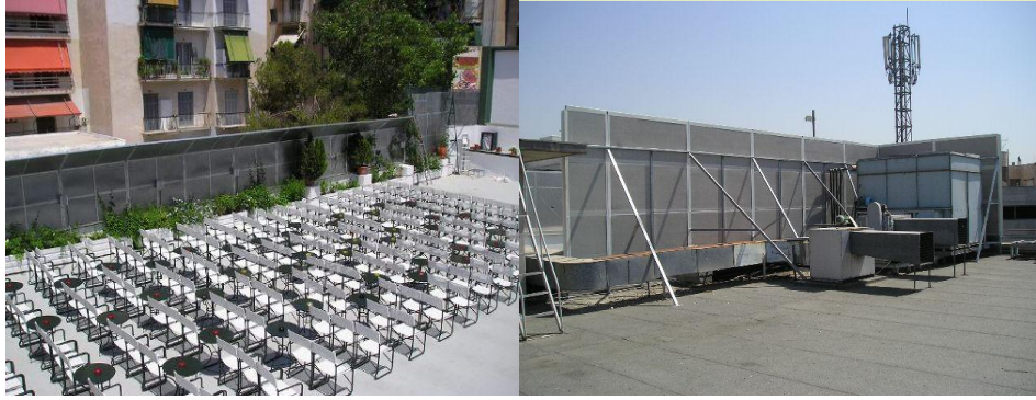
Μεταλλικά ηχοπετάσματα σε θερινό κινηματογράφο(αριστερά) και σε κλιματιστική εγκατάσταση
