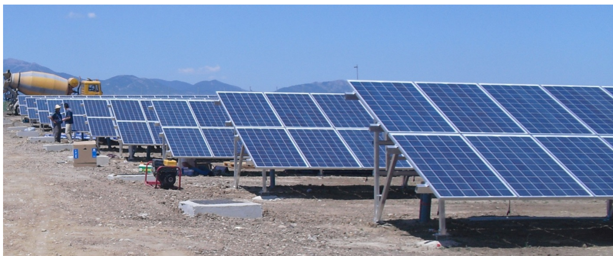
Εικόνα 5: Φωτοβολταϊκά πάνελ εγκατεστημένα σε φωτοβολταϊκό πάρκο. (Πηγή ιστοσελίδα Olympus trade group [9] )
