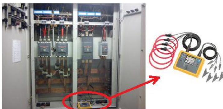
Εικόνα 4.33: Σύνδεση του αναλυτή ηλεκτρικής ενέργειας Fluke 1735 στον πίνακα χαμηλής τάσης
