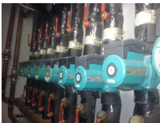
Εικόνα 3.5: Κυκλοφορητές ζεστού νερού
