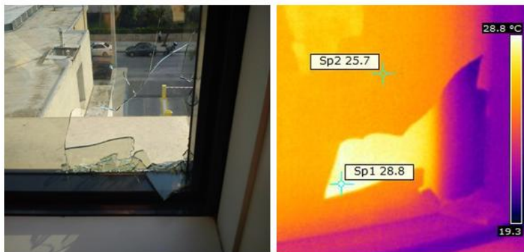
Εικόνα 4.26: Λεπτομέρεια σπασμένου υαλοπίνακα όπως φαίνεται από το εσωτερικό του κτιρίου
