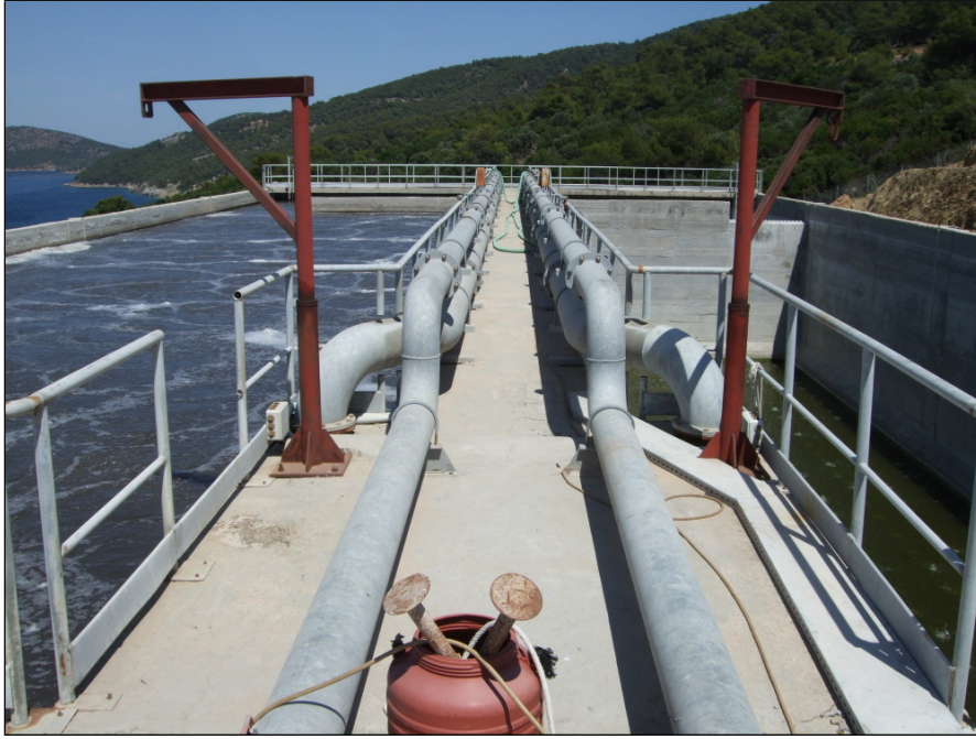
Σχήμα Β΄.4: Δεξαμενές αερισμού. Η δεξιά εξ αυτών είναι εκτός λειτουργίας, καθώς μια δεξαμενή αρκεί για τις παροχές κατά την χειμερινή περίοδο.
