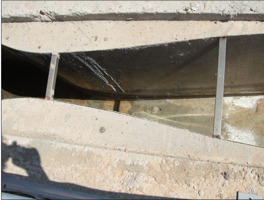
Σχήμα 1.4: Η γέφυρα Khafagi-Venturi της δεξαμενής χλωρίωσης.
