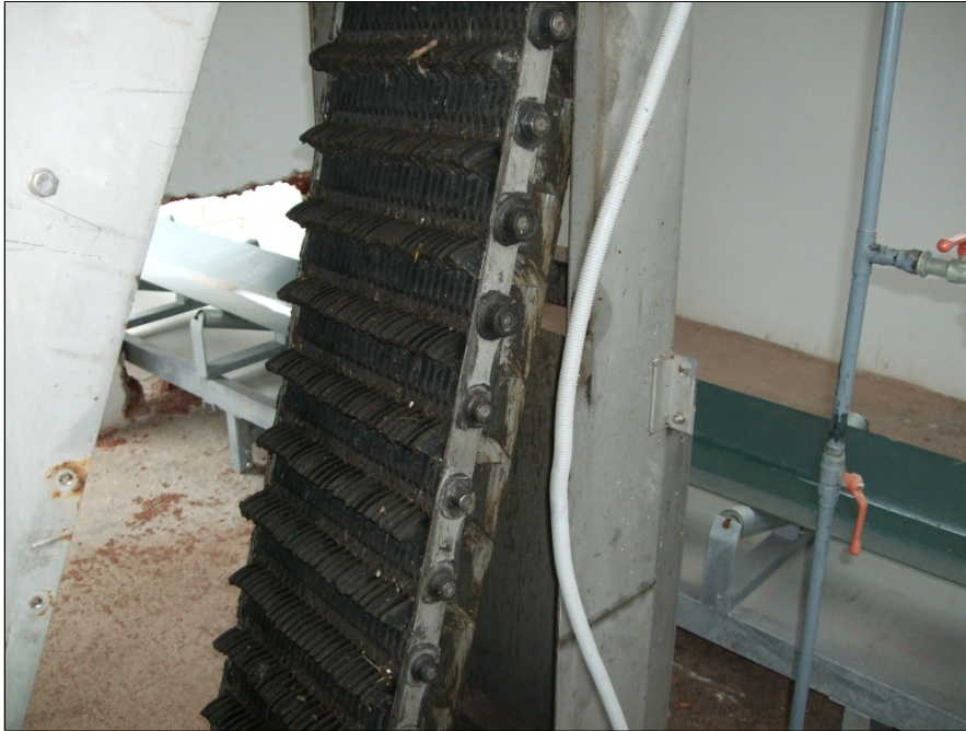
Σχήμα 1.9: Η αυτόματη εσχάρα της φωτογραφίας έχει χάσει μια πλειάδα από τα ράουλα αυτής με αποτέλεσμα να αδυνατεί να λειτουργήσει.
