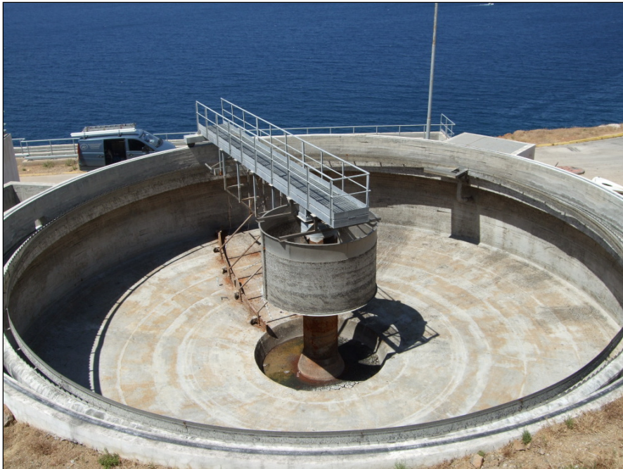
Σχήμα Β'.3: Κενή δεξαμενή καθίζησης
