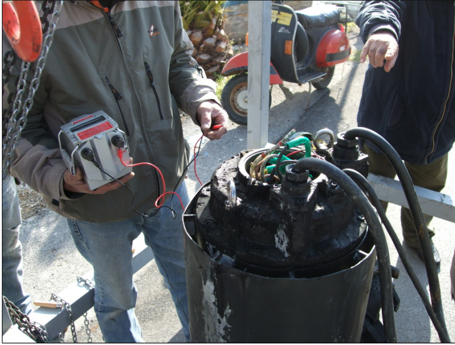
Σχήμα Β΄.8: Η αντλία λυμάτων του αποχετευτικού συστήματος ανοίχθηκε στο σημείο των ακροδεκτών των τυλιγμάτων της προκειμένου να μετρηθεί η ποιότητα της μόνωσης αυτών με ένα όργανο μέτρησης Megger.
