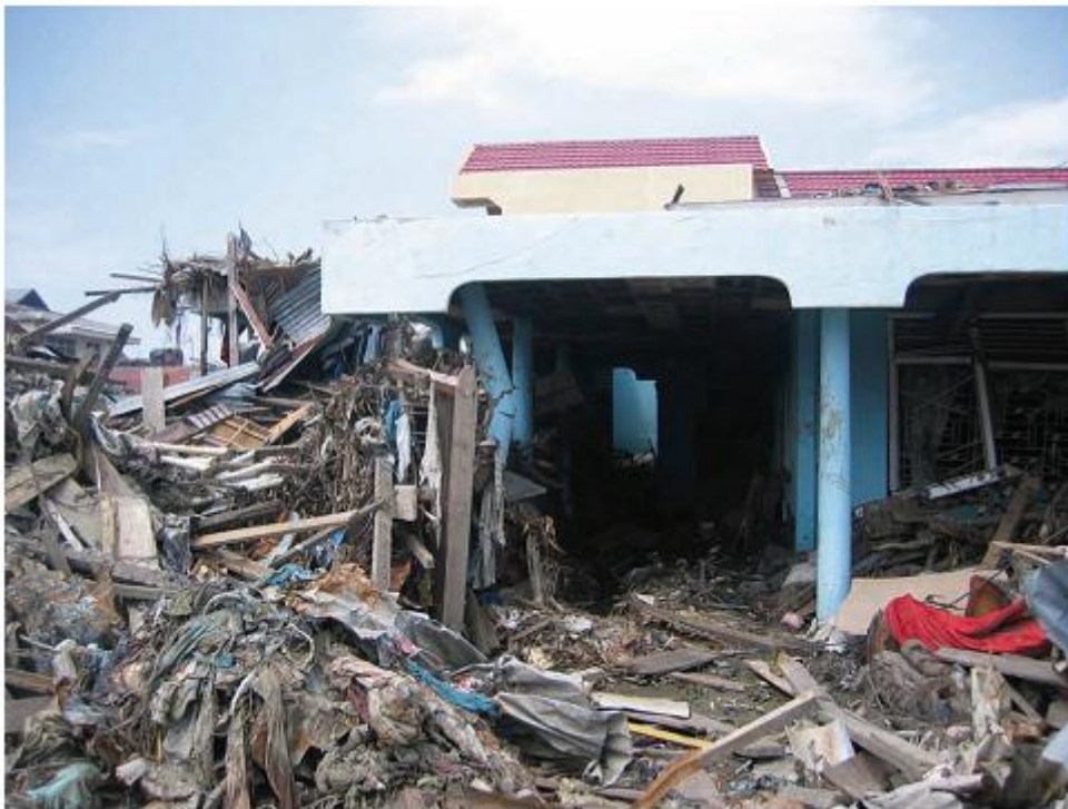
Σχ. 1.12 Βλάβη σε γωνιακή κολόνα εξαιτίας του φράγματος συντριμμιών
