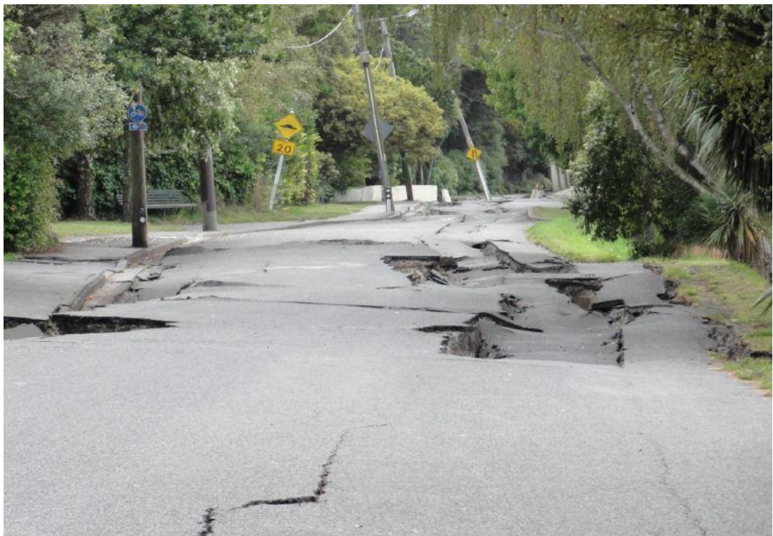
Εικόνα 3.14: οριζόντια εξάπλωση του εδάφους λόγω ρευστοποίησης (πηγή: Russell A. Green, Ιούνιος 2011, φωτογραφία από M. Cubrinovski)
