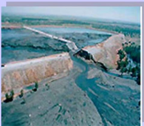
Εικόνα 1: Κατάρρευση φράγματος στο Aznalcóllar
