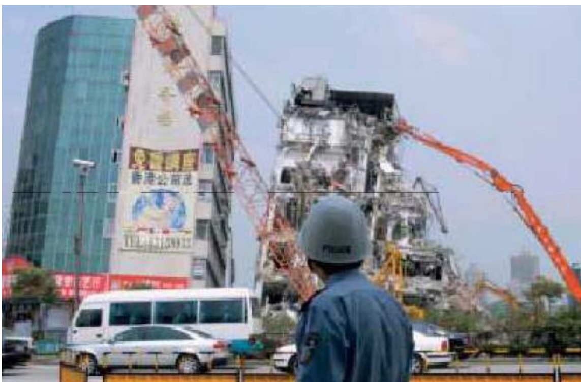
Εικόνα 1–14, Καθίζηση πολυώροφου κτιρίου στη Σανγκάη από την κατασκευή του Μετρό, Πηγή: Boos et al. 2004
