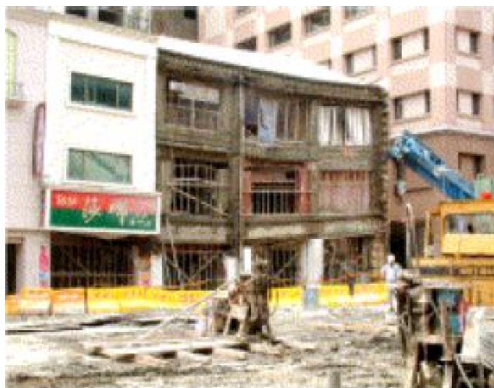
Εικόνα 1-16, Ζημιές σε γειτονικό κτίριο από την αστοχία στη σήραγγα Kaohsiung, Πηγή: Lee & Ishihara 2010
