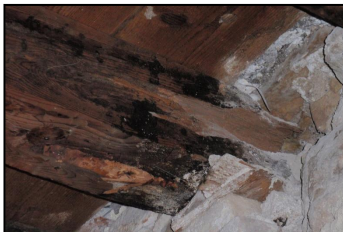
Εικόνα 20: Διάβρωση δοκού από υγρασία
