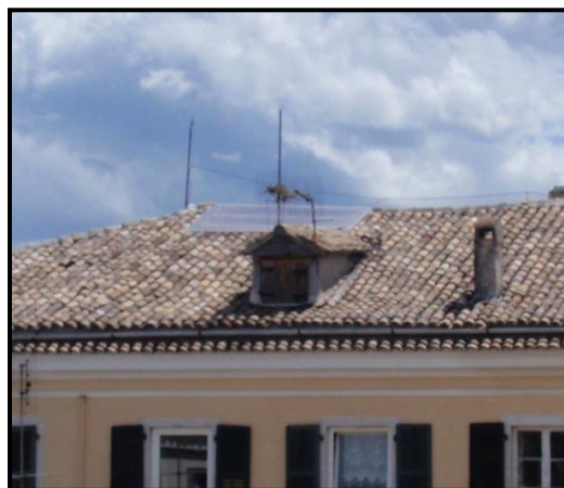
Εικόνα 16: Κατασκευή για πρόσβαση στη στέγη
