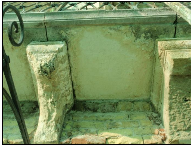
Εικόνα 27: Διάβρωση σε φουρούσι
