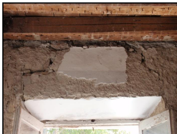
Εικόνα 22: Διατμητικές ρωγμές σε ανώφλι
