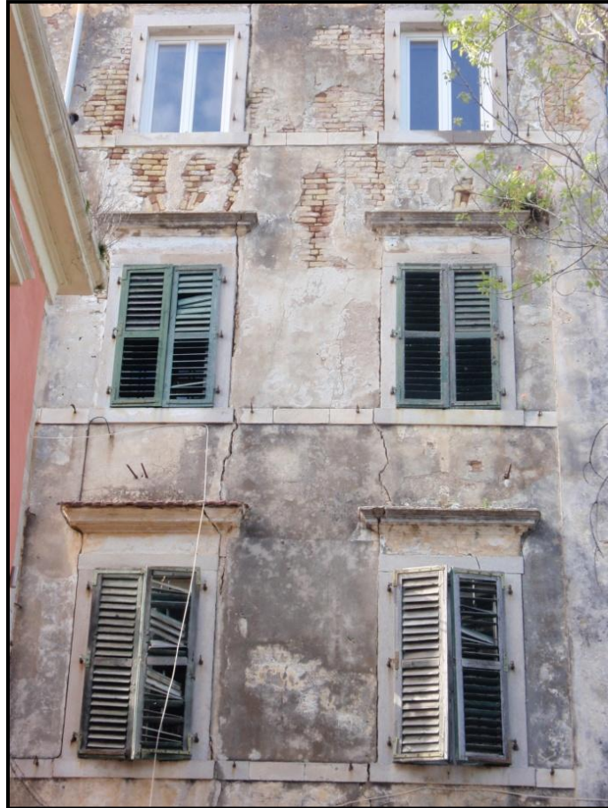
Εικόνα 21: Κατακόρυφες ρωγμές στη νότια όψη
