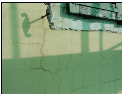
Εικόνα 24: Ρωγμές από διάβρωση σπλισμού
