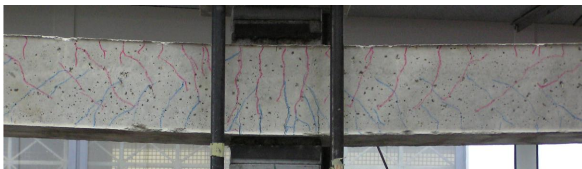
Εικόνα 22: Δοκός Δ5: ρωγμές εντός διαμητικού μήκους. Συγκέντρωση ρωγμών στο σημείο επιβολής της φόρτισης
