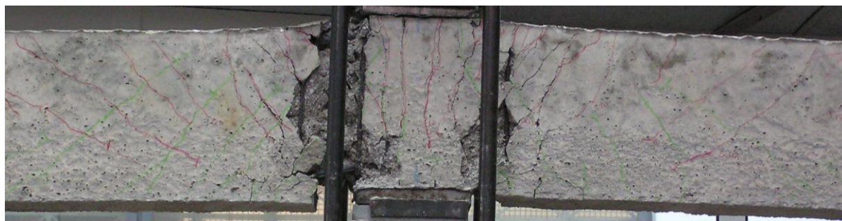
Εικόνα 19: Δοκός Δ3: ρηγματωμένη κατάσταση φορέα
