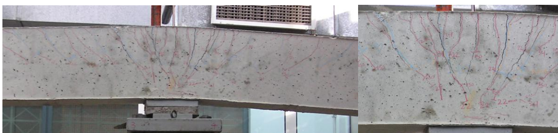
Εικόνα 12: Δοκός Δ1: συγκέντρωση καμπτοδιαμητικών ρωγμών στο σημείο επιβολής της φόρτισης
