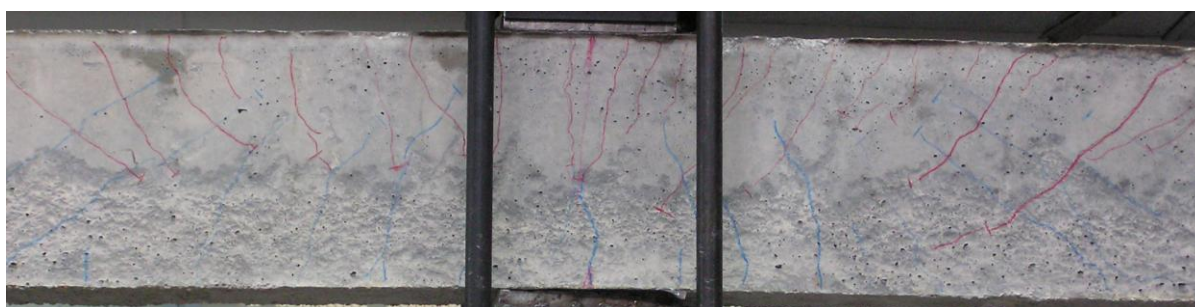
Εικόνα 20: Δοκός Δ4: Ρωγμές εντός διαμητρικού μήκους. Συγκέντρωση ρωγμών στο σημείο επιβολής της φόρτισης
