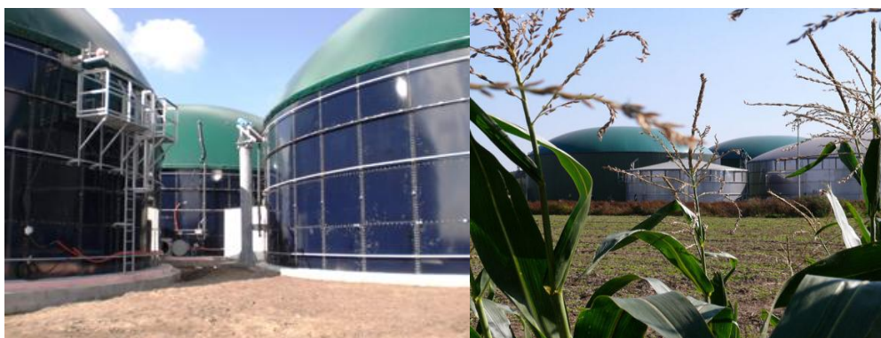
Σχήμα 2.7. Κάθετοι χωνευτήρες μεταλλικής κατασκευής για παραγωγή βιοαερίου αριστερά (ZORG), μονάδα αναερόβιας χώνευσης δεξιά (Autev Engineering A.E.)
