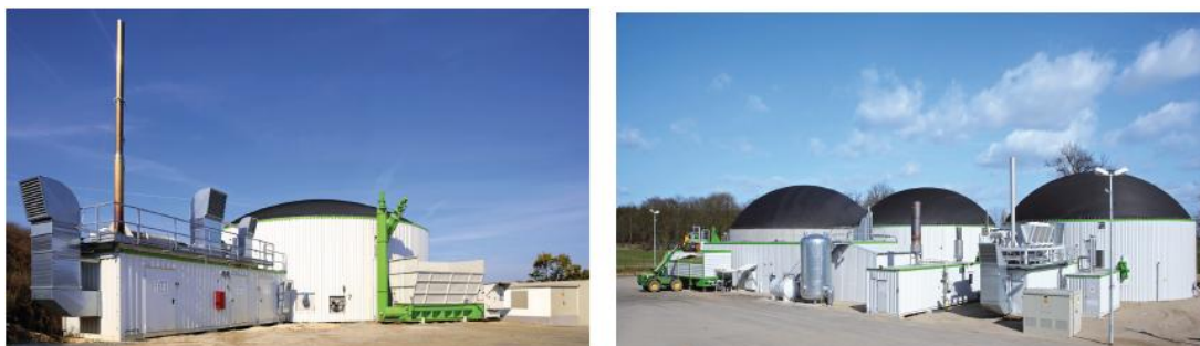
Σχήμα 2.5. Μονάδα βιοαερίου κλίμακας αγροκτήματος (Duggan Energy Brochure)
