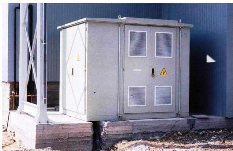
Εικόνα 3.2: Υποσταθμός μεσαίας τάσης
