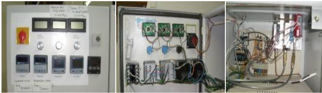
Εικόνα 3.1.3: Πίνακας Ελέγχου του συστήματος καθαρισμού αερίου
