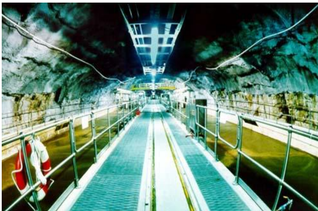
Εικόνα 3.16 Υπόγειος θάλαμος της κύριας επεξεργασίας λυμάτων
