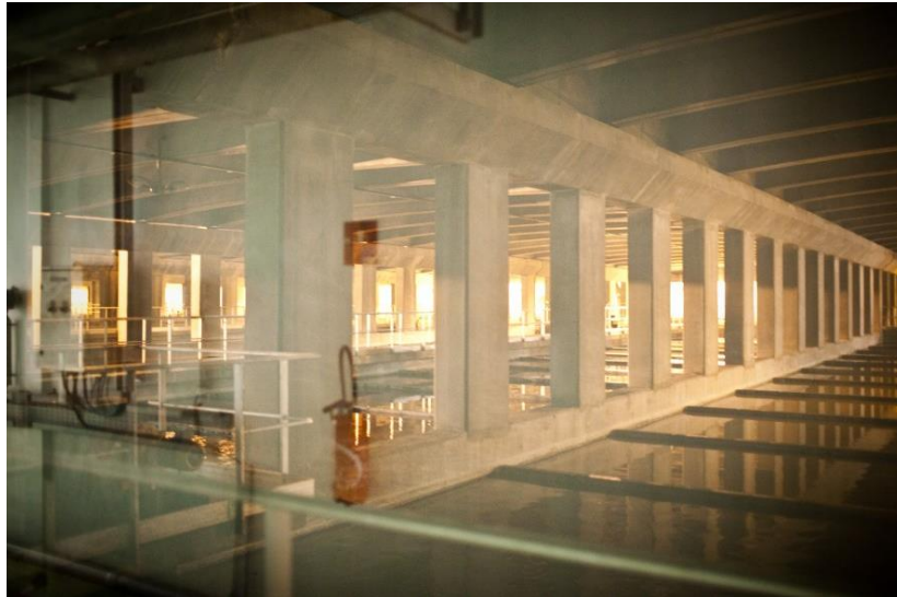
Εικόνα 3.11 Άποψη του εσωτερικού χώρου των υπόγειων δεξαμενών επεξεργασίας του Genolide STP
