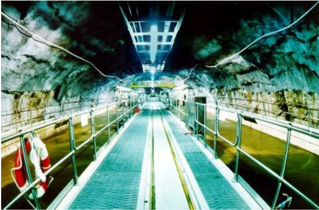
Εικόνα 3.15 Υπόγειος θάλαμος της κύριας επεξεργασίας λυμάτων
