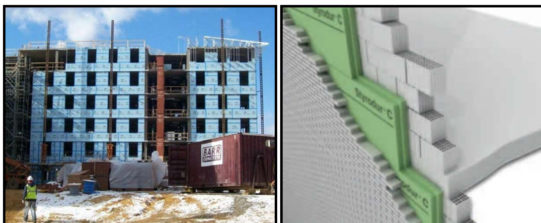
Εικ. 3.17: Τοποθέτηση πλακών αφρώδους εξηλασμένης πολυστερίνης εξωτερικά των δομικών στοιχείων και στον πυρήνα της τοιχοποιίας.
