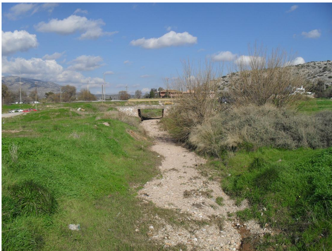
Φωτογραφία 18: Αποθέσεις στην κοίτη του χειμάρρου στην παραλία της Βάρκιζας.
