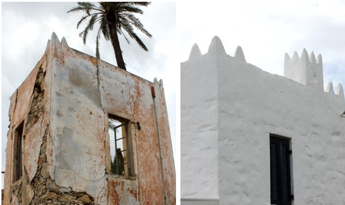
Εικόνα 4.9: Διώροφες κατοικίες στα Άλιντα και στο Λακκί Λέρου με αιχμηρές απολήξεις στις γωνίες της στέγης, απομίμηση των οδοντωτών επάλξεων των πυργόσπιτων του νησιού
