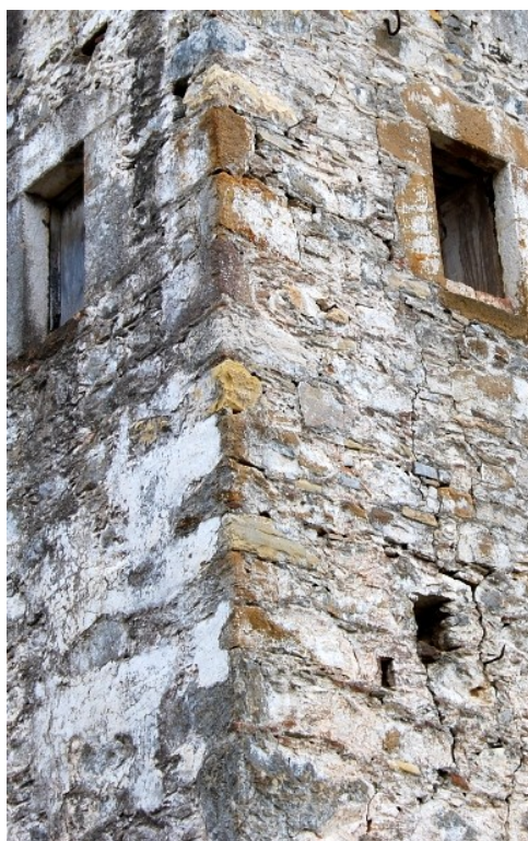
Εικόνα 7.2: Η ΒΔ γωνία του κτίσματος, σε ύψος 4-5 μ. περίπου. Διακρίνεται η επικίνδυνη ρηγμάτωση
