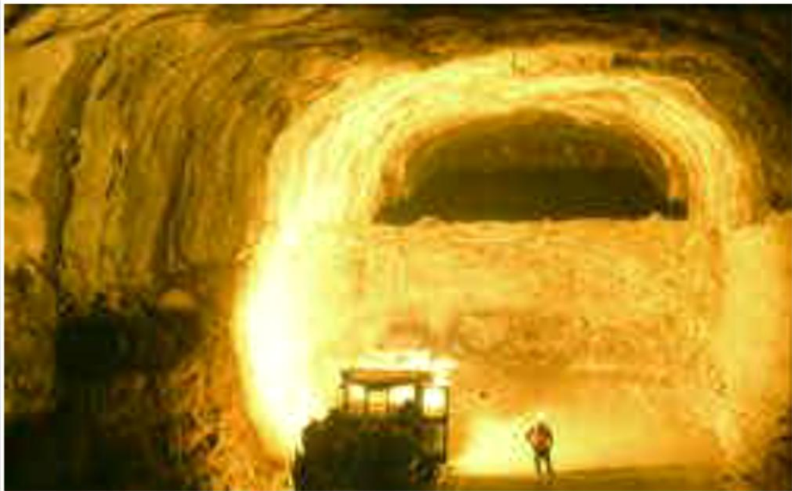
Εικόνα 5.14: Όρυξη βαθμίδας κατά την δημιουργία υπόγειου θαλάμου αποθήκευσης υδρογονανθράκων στο Σύδνεϋ στην Αυστραλία.
