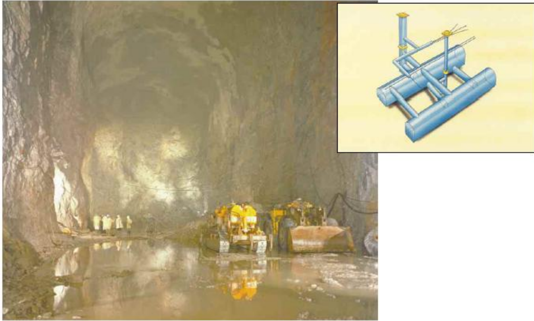
Εικόνα 5.8: Εσωτερικό και απεικόνιση υπόγειων θαλάμων αποθήκευσης στη Donge.
