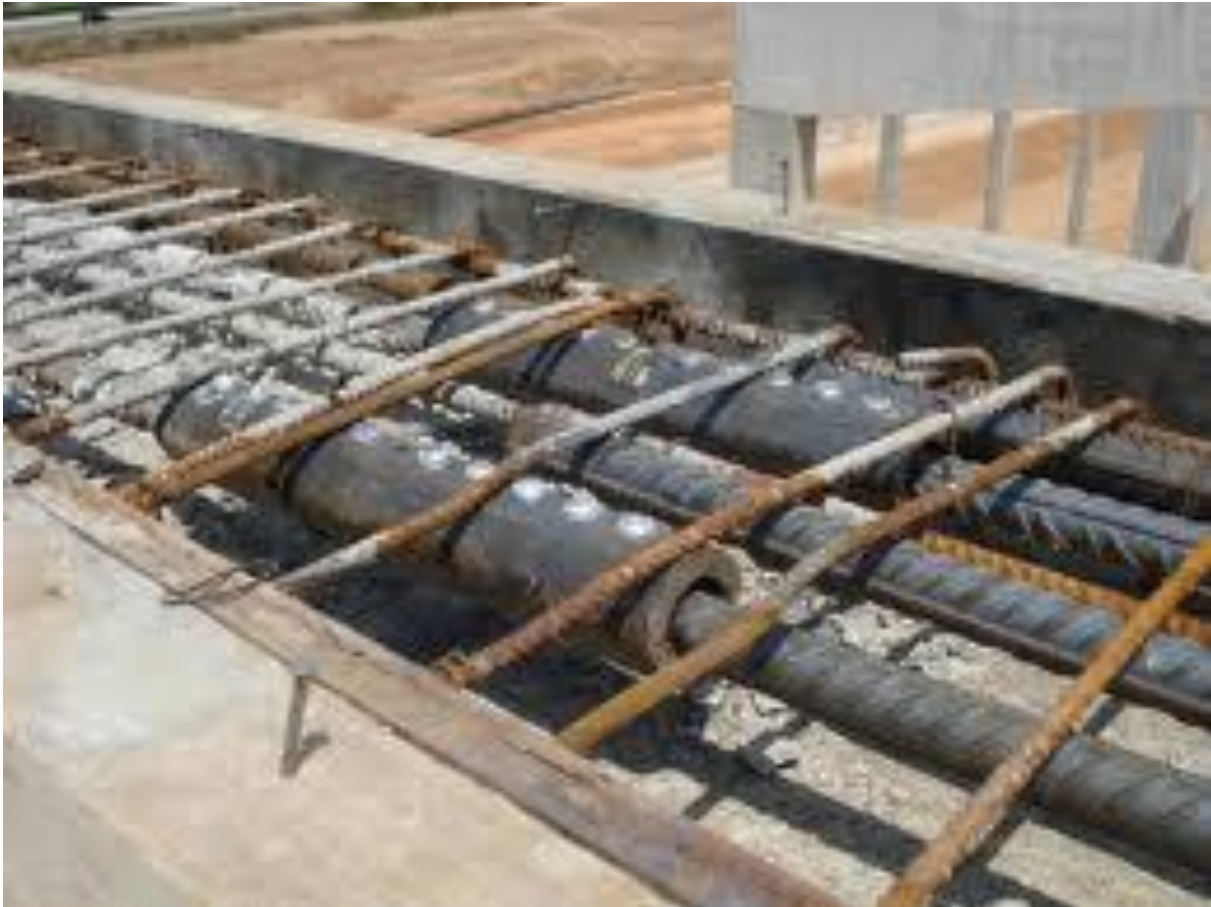
Εικόνα 4: Ένωση με μηχανικά μέσα (couplers), με εμφανές το πρόβλημα της ανεπαρκούς πλευρικής εξασφάλισης των διαμήκων οπλισμών έναντι λυγισμού από τους συνδετήρες
