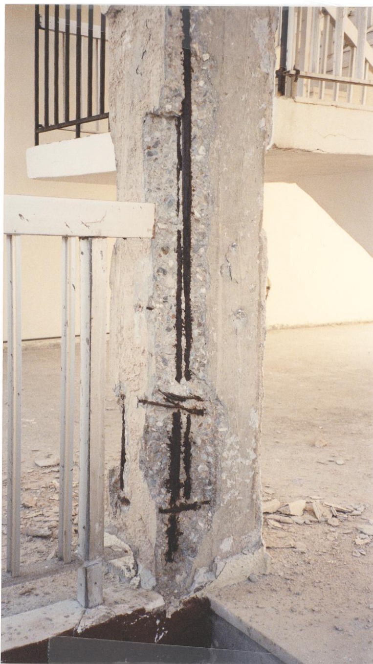
Εικόνα 13: Αστοχίες σε κατακόρυφα στοιχεία (υποστυλώματα) ΟΣ με «επαρκές» μήκος παράθεσης και ελλιπή εγκάρσιο οπλισμό
