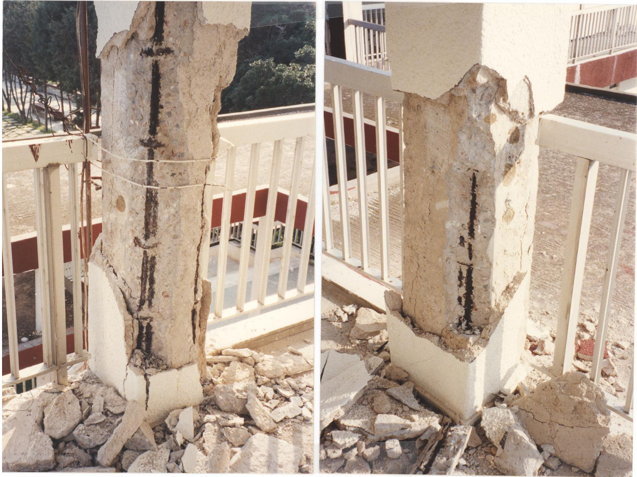
Εικόνα 11: Αστοχίες σε κατακόρυφα στοιχεία (υποστυλώματα) ΟΣ με ανεπαρκές μήκος παράθεσης και ελλιπή εγκάρσιο οπλισμό
