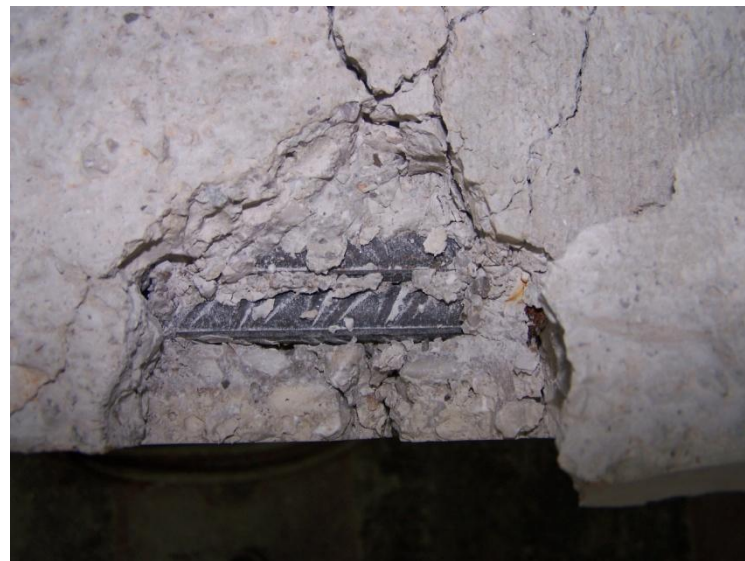
Εικόνα 19: Λεπτομέρεια αποφλοιωμένου σκυροδέματος στο δοκίμιο L30D1 στην περιοχή της ένωσης
