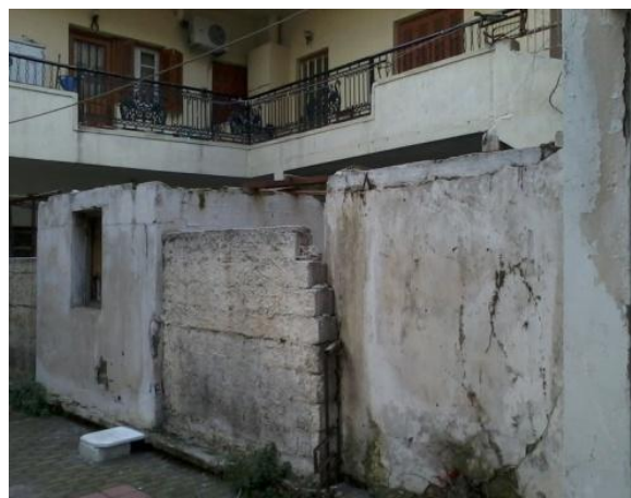
Εικόνα 68 - Εγκαταλελειμμένο κτίσμα και κατοικία
