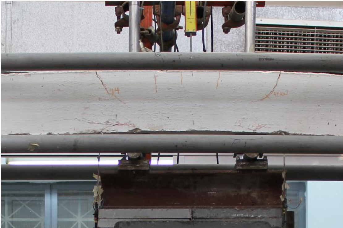
ΕΙΚΟΝΑ 47 Αύξηση του εύρους και του ύψους της οριζόντιας ρωγμής
