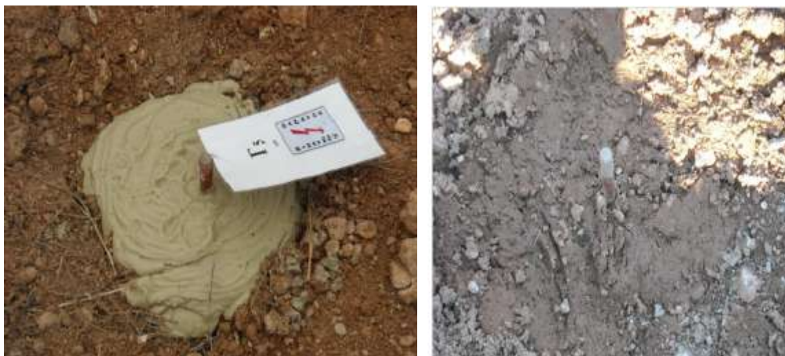
Εικόνα 4.3: Ηλεκτρόδια γείωσης εμβαπτισμένα σε χημικά βελτιωτικά υλικά [2].
