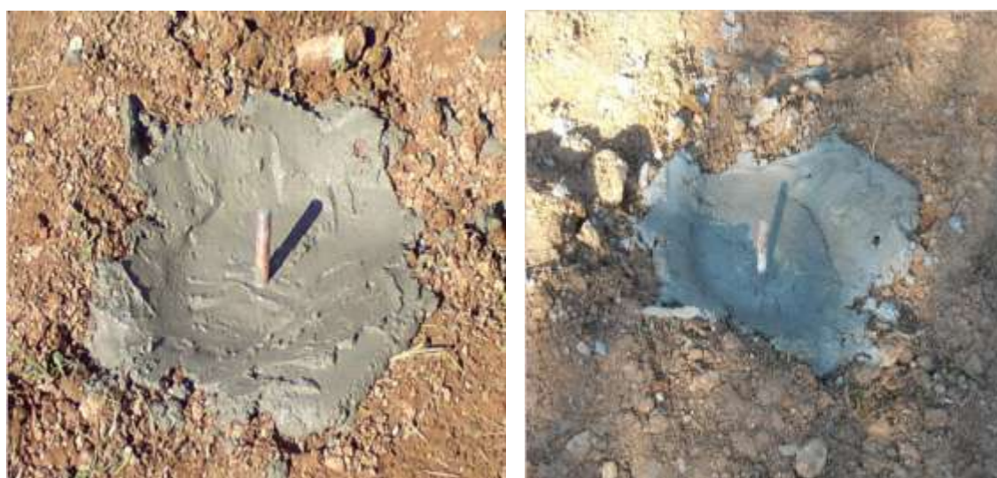
Εικόνα 4.4: Ηλεκτρόδια γείωσης εμβαπτισμένα σε μπετονίτη και σκυρόδεμα [2].
