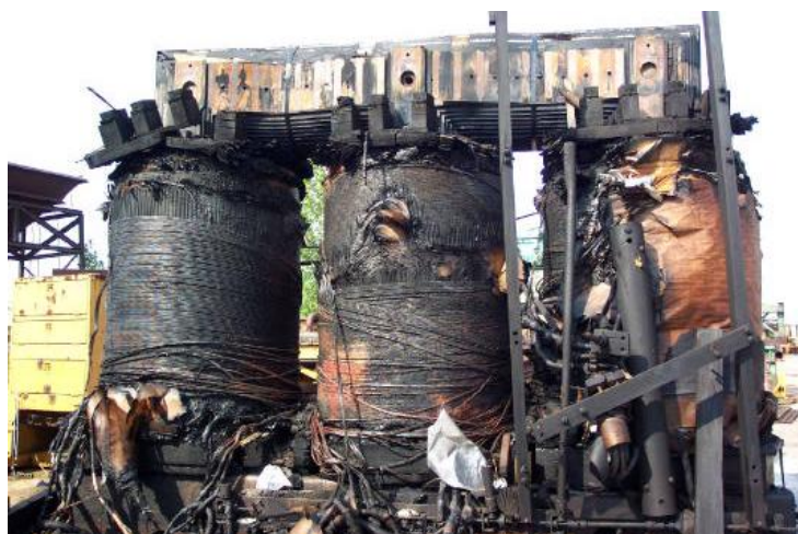
Σχήμα 5.10 Μετασχηματιστής λαδιού έπειτα από έκρηξη που προηγήθηκε από αστοχία στο εσωτερικό του
