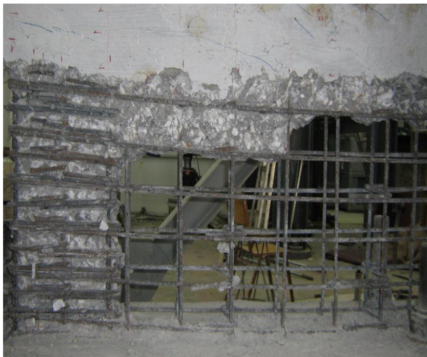
Φωτογραφία 10. Μορφή κατασκευής πριν την επισκευή (β)
