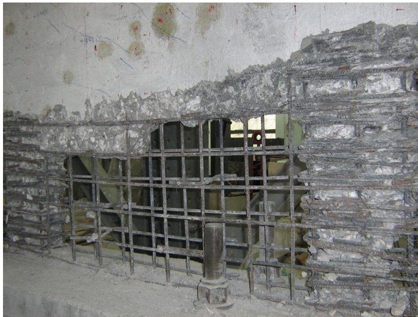
Φωτογραφία 9. Μορφή κατασκευής πριν την επισκευή (α)
