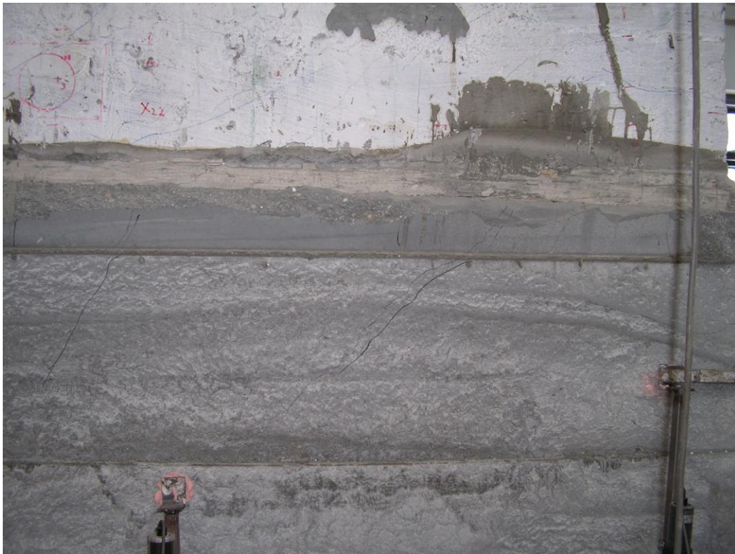
Φωτογραφία 21: εμφάνιση ρωγμών στο τοιχίο
