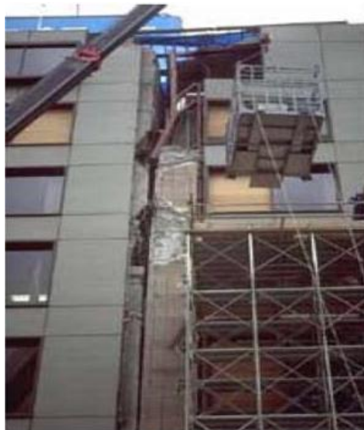
Εικόνα 1.6 - Κόμπε, Ιαπωνία - Βλάβες από την κρούση όμορων κτιρίων λόγω σεισμού
