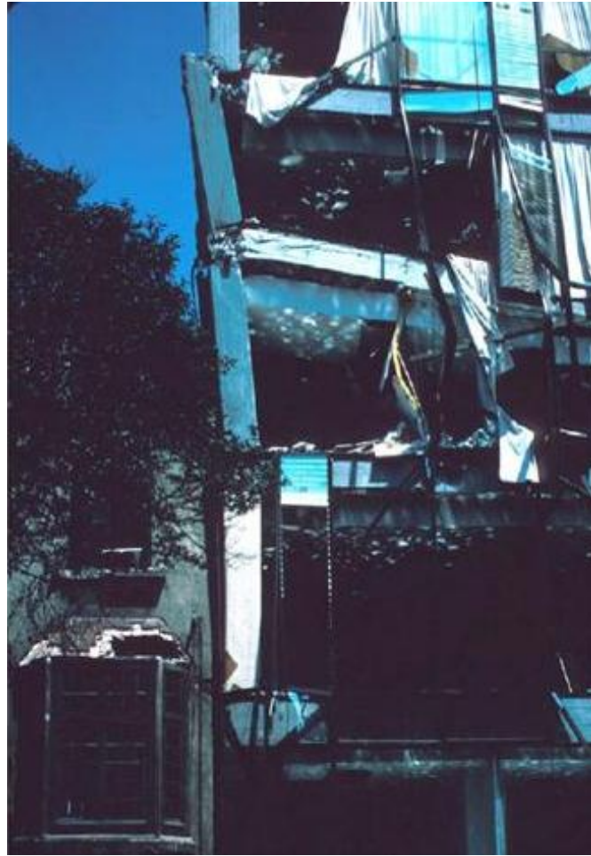
Εικόνα 1.3 – Μεξικό 1985 – Δυσμενέστερη περίπτωση κρούσης όμορων κτιρίων λόγω σεισμού – κατάρρευση 8-όροφου κτιρίου
