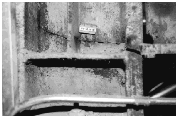
Σχήμα 10.3: Ρηγματώση που πλήττει τον κορμό του υποστυλώματος κατά το σεισμό του Northridge [132]
