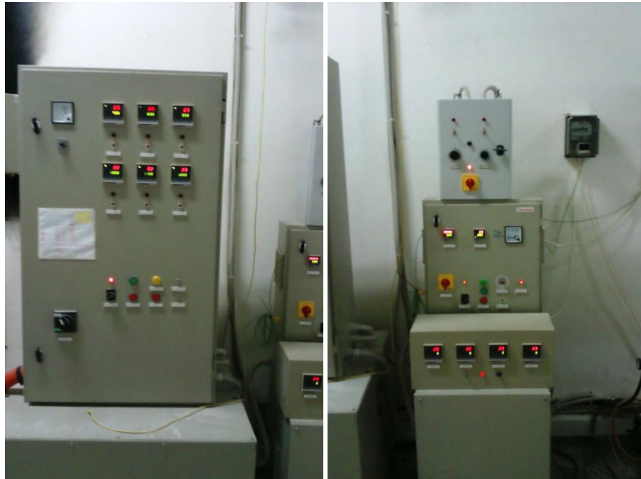
Σχήμα 4.10. Πίνακας ελέγχου θερμοκρασίας καμίνου και συστήματος δόνησης (αριστερά) και πίνακας ελέγχου λειτουργίας προθερμαντήρα αέρα, τροφοδότη και αναδευτήρα σιλό τροφοδοσίας (δεξιά).
