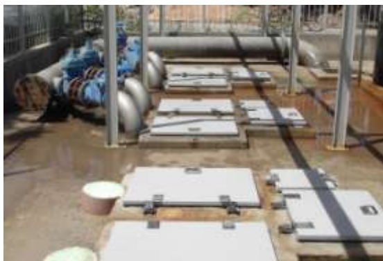
Φωτογραφία 6.1: Το αντλιοστάσιο υγρών αποβλήτων της ΕΕΛ Πρέβεζας
