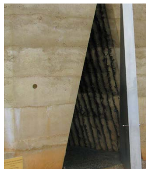
Εικ. 53: Αλλαγή της υφής του σκυροδέματος από το εσωτερικό στο εξωτερικό
