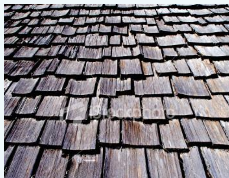
εικόνα 6: Καταστροφή ξύλινης στέγης καιρικές συνθήκες. (Πηγή: www.christianforums.com )
