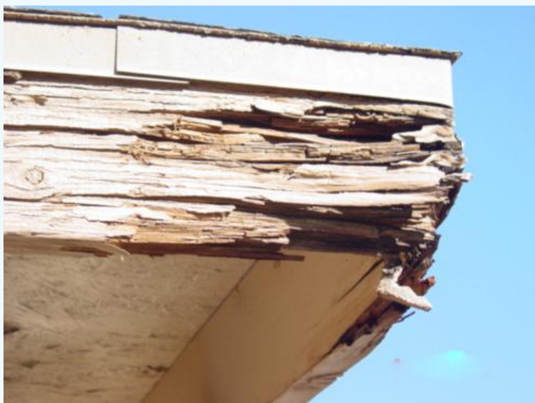
εικόνα 5: Καταστροφή τμήματος ξύλινης στέγης από το νερό. (Πηγή: http://probestpest.tumblr.com )
