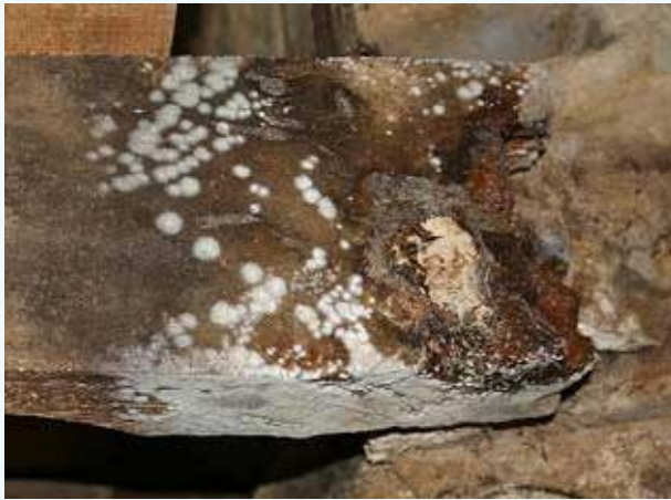
εικόνα 1: Ξύλο που έχει προσβληθεί από μύκητες. (Πηγή: www.timber-repair.co.uk )
