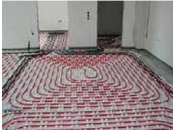
Εικόνα 30 - Ενδοδαπέδιο σύστημα θέρμανσης (48)
