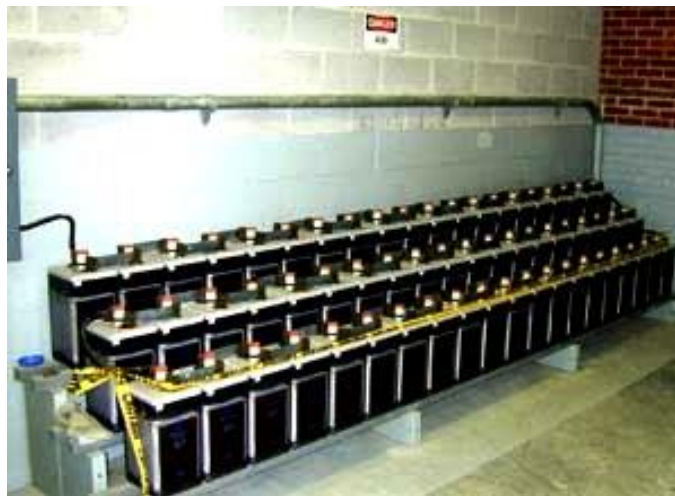
Εικόνα 1.16: Παράδειγμα υποσυστήματος μπαταριών σε υποσταθμό [9]
