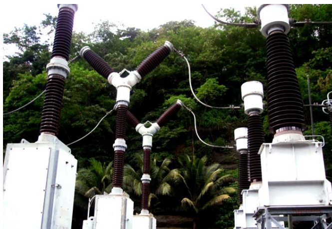
Εικόνα 1.11: Μετασχηματιστές εντάσεως (δεξιά) συνδεδεμένοι με διακόπτες ισχύος (αριστερά) [4]
